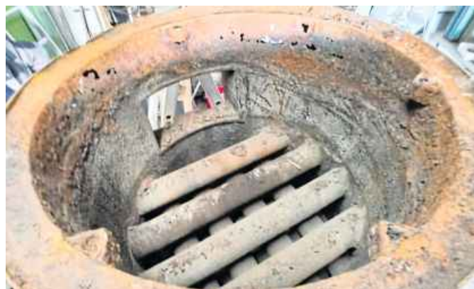
Das Alter, die Hitze und der Rost hatten der Brennkammer gewaltig zugesetzt. Da half nur reichlich neues Material.
