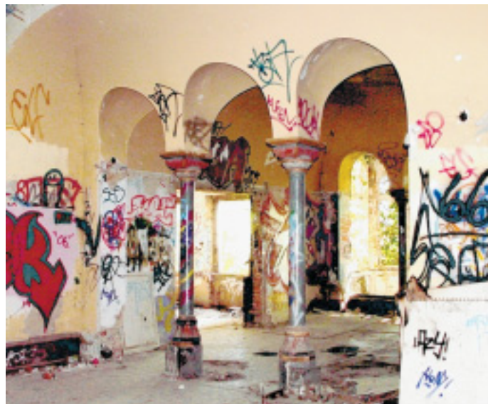
Die Villa heute: Mehrmals hat es hier gebrannt. Große Teile der Einrichtung sind zerstört.
